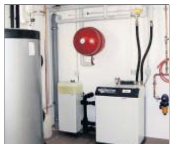
Klein im Format, riesig in der Wirkung: die Heizanlage
