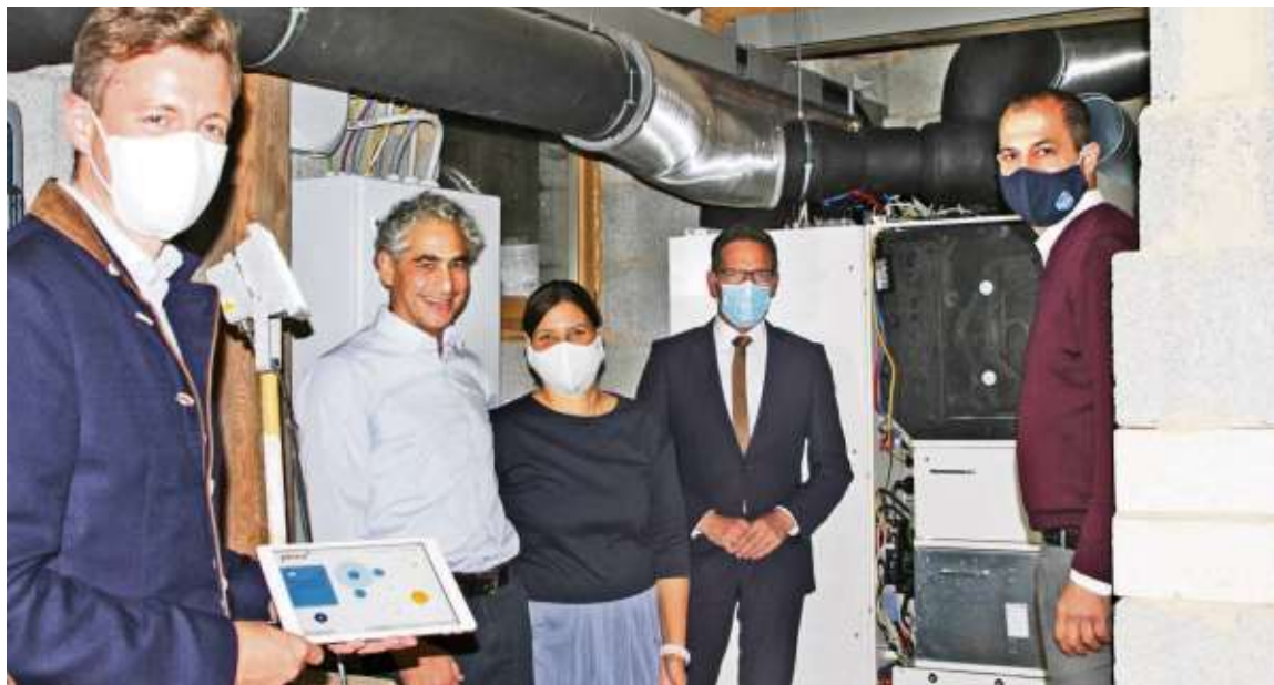
Zeyad Abul-Ella (rechts) erläuterte die Technik der ersten Wasserstoff-Speicheranlage. Landrat Oliver Bär, Robi und Kati Banerjee sowie Bürgermeister Michael Abraham (von links) freuen sich über das Engagement der Energie-Pioniere im Rehauer Ortsteil Wüstenbrunn. Foto: flo
