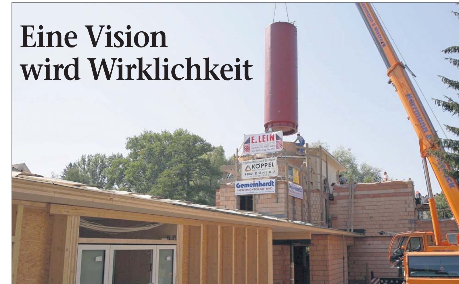
Ein 40 000 Liter großer Solar-Speichertank bevorratet die Wärme des Sommers. Sie wird im Winter zum Heizen genutzt.
