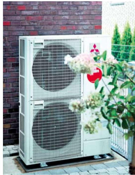
Die Heizung steht im Garten – „Zubadan“-Außengerät von Mitsubishi Electric
